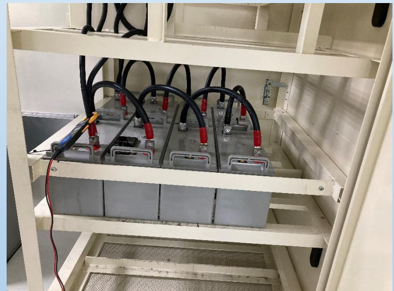
新電池組安裝完成
