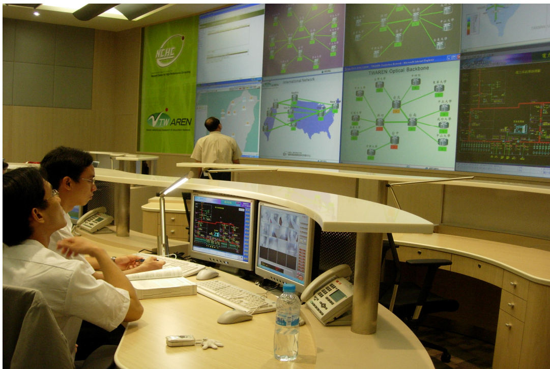
TWAREN 監控中心 (NOC, Network Operation Center) 網路監控實景
